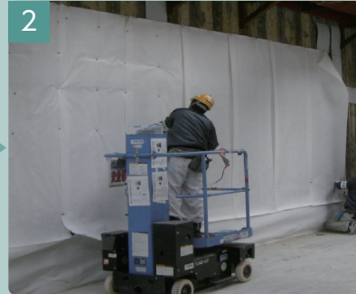
2 SPベースシート張り 下地との浮きが極力無いように下地に沿って傘くぎなどで固定する。ジョイントは100mm以上確保し、ジョイントテープ等で口開きが無いように接着させる。
