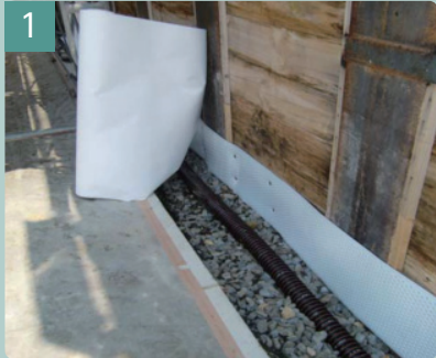
1 導水処理 SMW壁等は、導水パネルを設置する底部地盤には、割リグリ石に排水用の暗渠を設置する。
